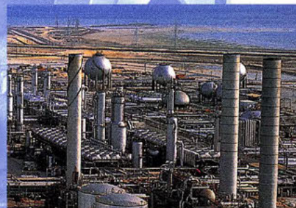
石油の採掘/精製プラント
